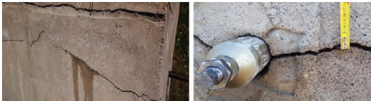
Рис. 3. Развитие трещин гидроразрыва в бетонном блоке
